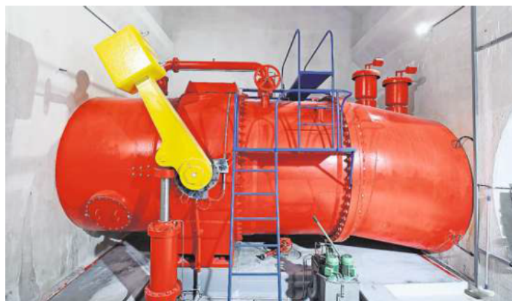
Die Druckleitung im revidierten Kraftwerk Wernisberg, welche das Wasser vom Selgis-Ausgleichsbecken auf die Turbinen führt. Bild: ebs Energie AG
