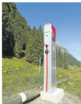
Die neue Stromtankstelle des EBS im Sahli. Bild: Archiv
