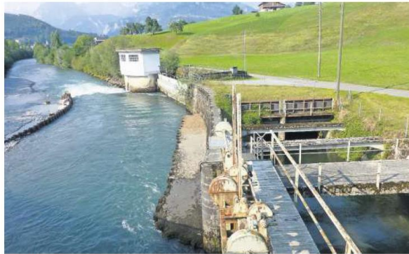
Die Wasserfassung bei der Einmündung der Seewern wird rückgebaut, die Muota ab diesem Bereich flussabwärts aufgeweitet. Bild: Franz Steinegger
